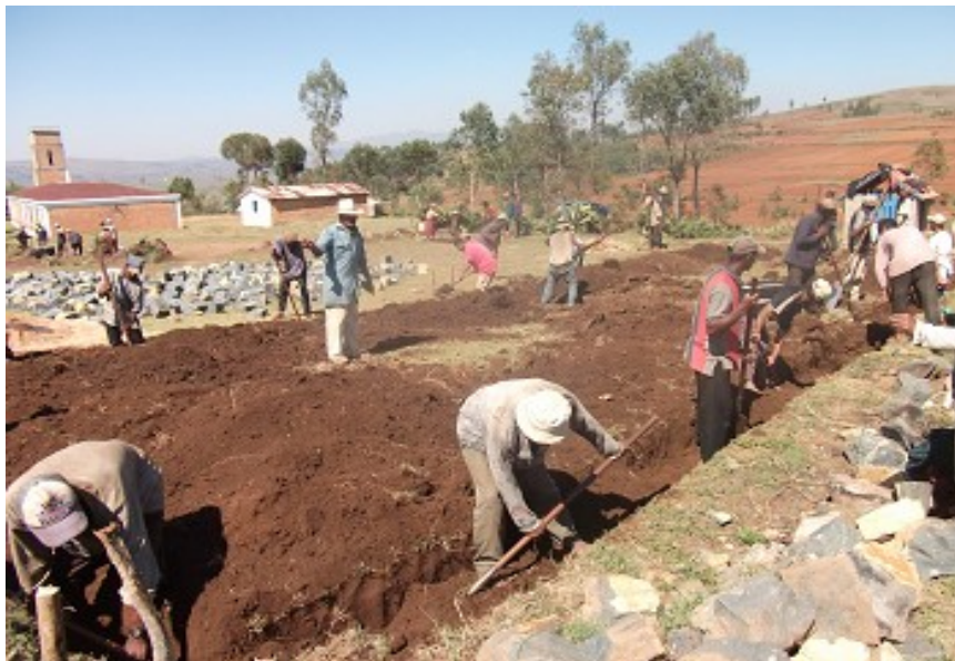
Mobilisation des parents pour la construction des deux classes primaires à Tsaramody
